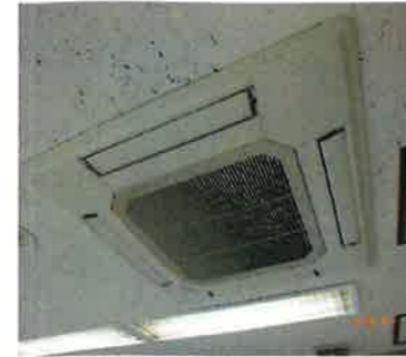
個別空調 (空調機2台)
